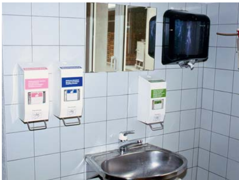
Fig. 18: stazione di lavaggio in una fabbrica di cemento con dispenser di crema e sapone e regolazione della temperatura dell'acqua.
