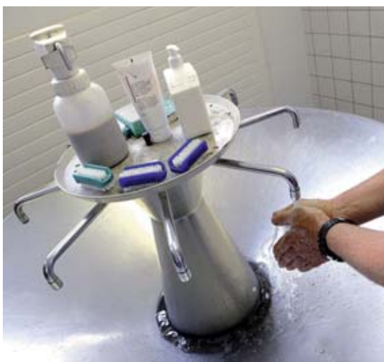
Fig. 17: stazione di lavaggio in un'azienda del settore metallurgico con diversi detergenti in funzione del tipo di sporcizia.
